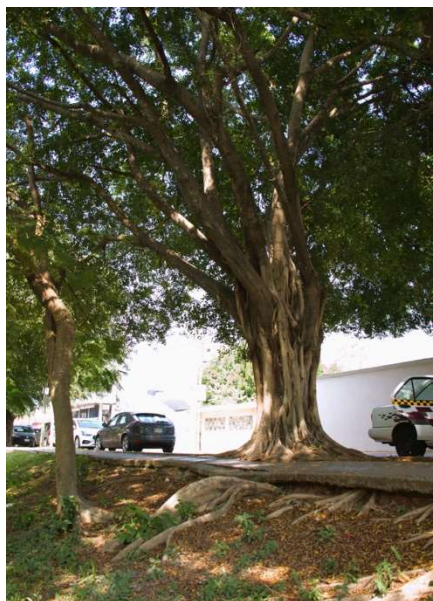
Fig. 9. Raíces del ficus afectando el paso peatonal.
