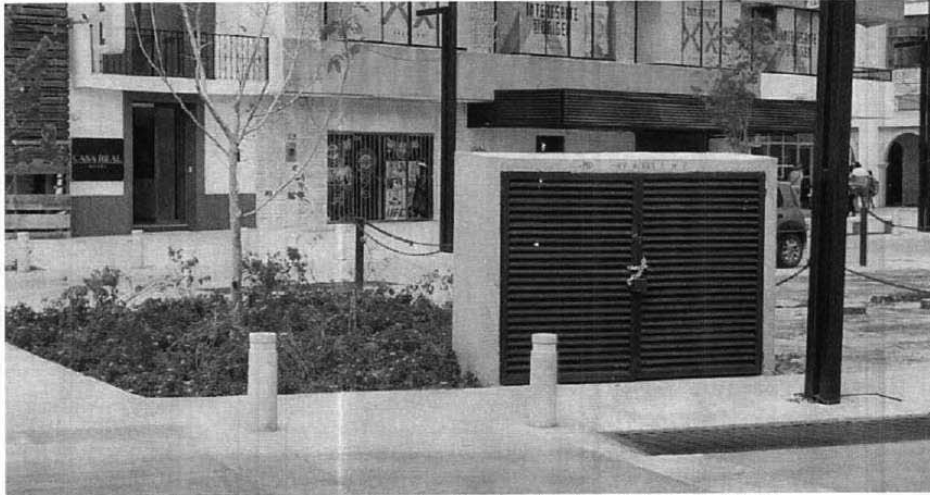
Figura 28. Fotografía. Mimetización de cajas de registro y medidores.
